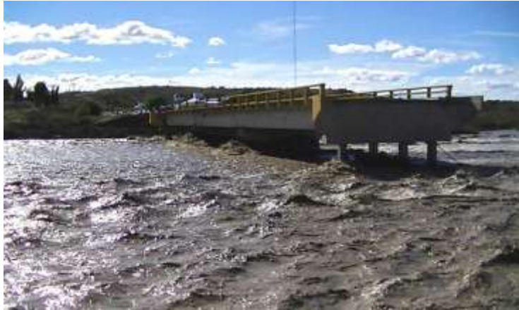
Un tramo del puente del Arroyo Verde sobre la Ruta Nacional N°3 se cayó por el temporal http://webcache.googleusercontent.com/search?q=cache:http://www.elchubut.com.ar/nota/86635/
